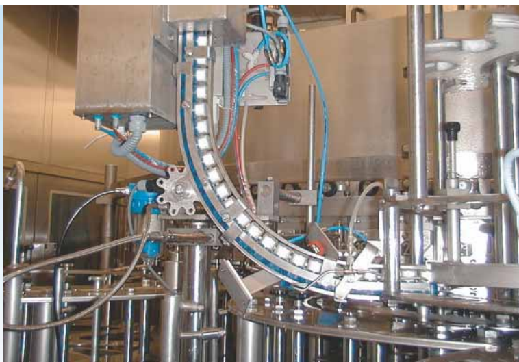
Entkeimung von Schraub- verschlüssen in einer Getränkeabfüllanlage
