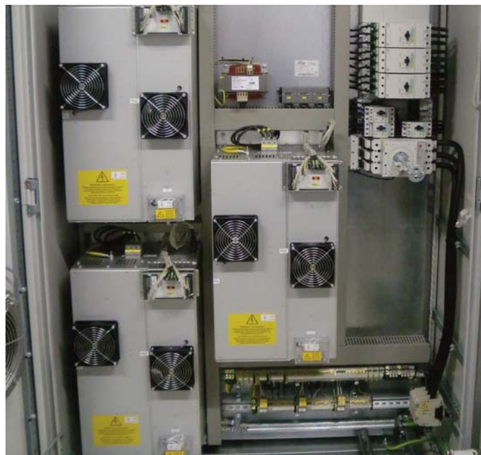
Armoire de commande avec ballasts EPS 340
